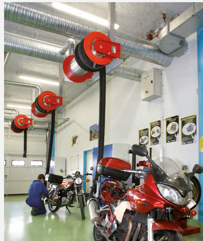
Installation d'aspiration de gaz d'échappement sur tambours.
